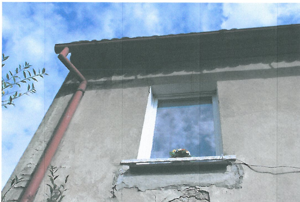
Zdjęcie nr 4 – Widoczne pęknięcia na elewacji tylnej
