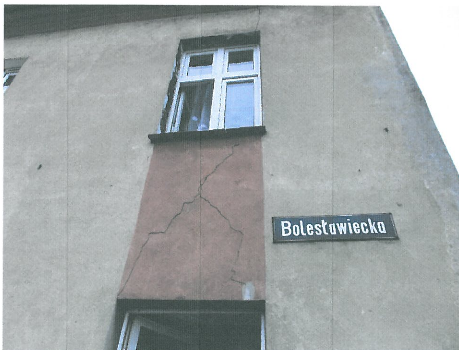
Zdjęcie nr 2 – Widoczne pęknięcia na elewacji frontowej
