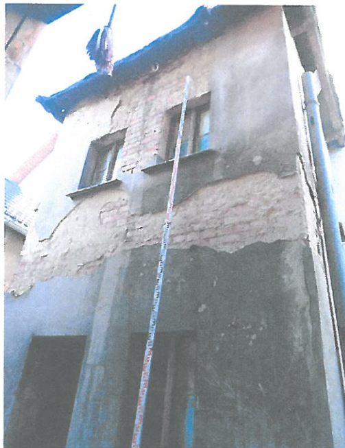
Uszkodzenia tynków, murów i stolarki części dobudowanej.
