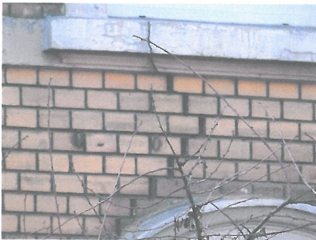
Charakterystyczne zarysowania ścian zewnętrznych.
