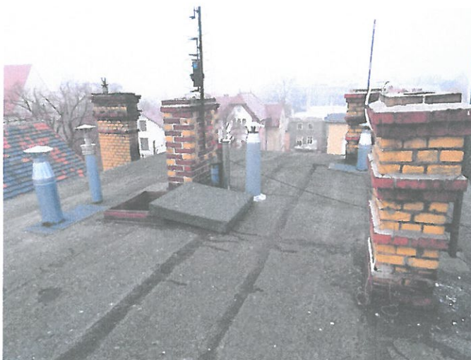
Zużyte pokrycie papowe, widoczne uszkodzone kominy.
