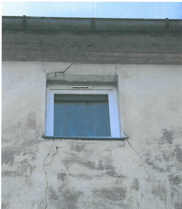
Zdjęcie nr 2 – Widoczne pęknięcia na elewacji frontowej
