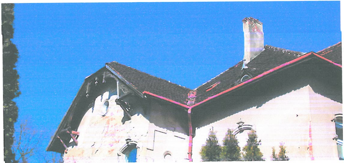
Zdjęcie nr 3 – Połąć dachu południowa
