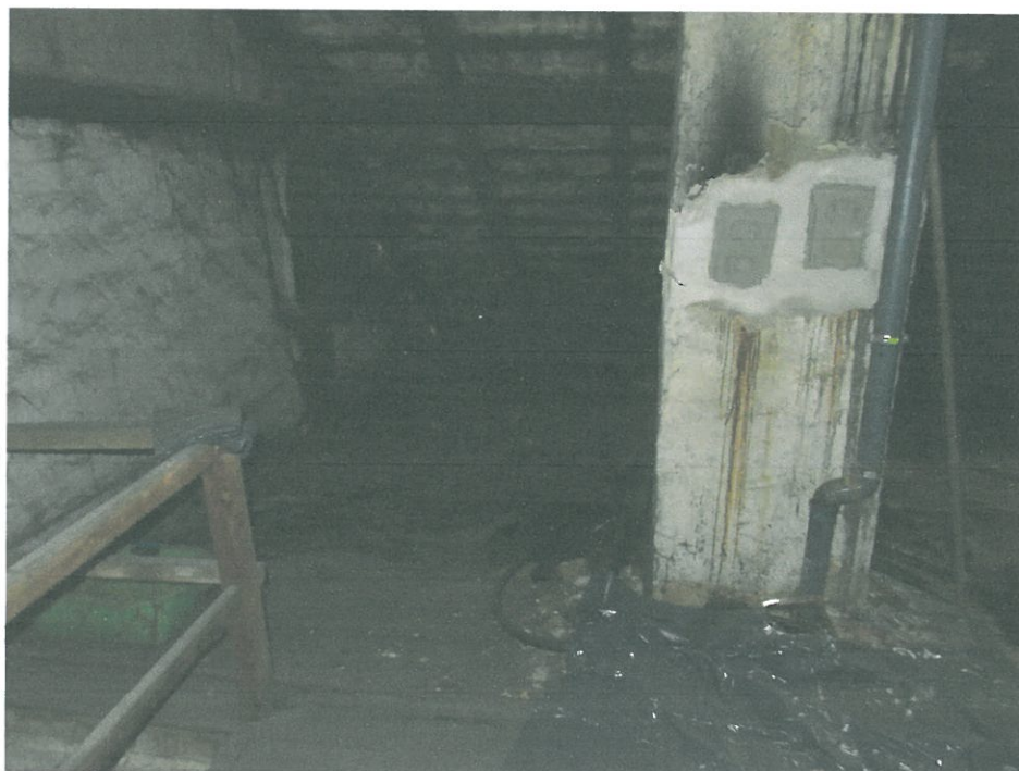
Zdjęcie nr 5 – Widoczne zacieki na kominie
