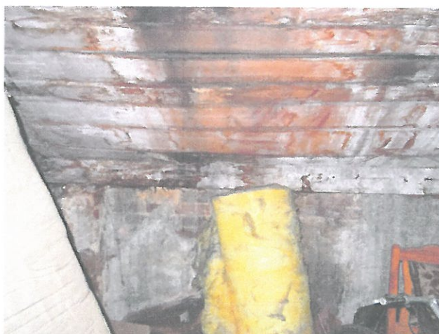
Uszkodzenia i zawilgocenie płatwi stolcowej oraz deskowania w pom. gospodarczym na poddaszu.
