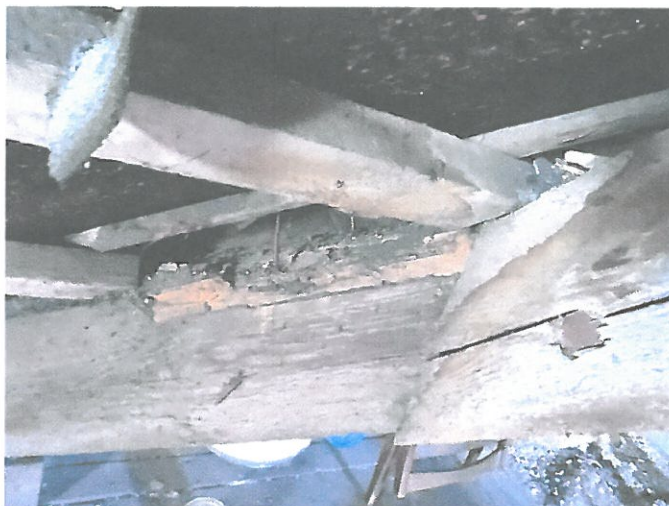
Korozja biologiczna krokwi koszowej.
