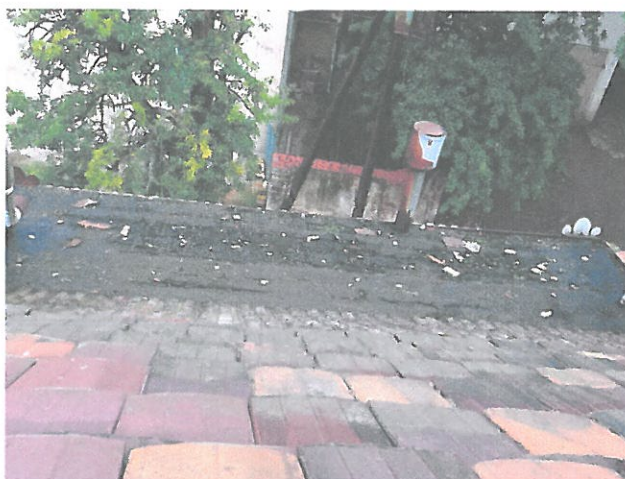
Uszkodzenia pokrycia z papy nad ryzalitem klatki schodowej.
