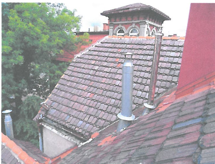
Uszkodzenia pokrycia z dachówki ceramicznej.
