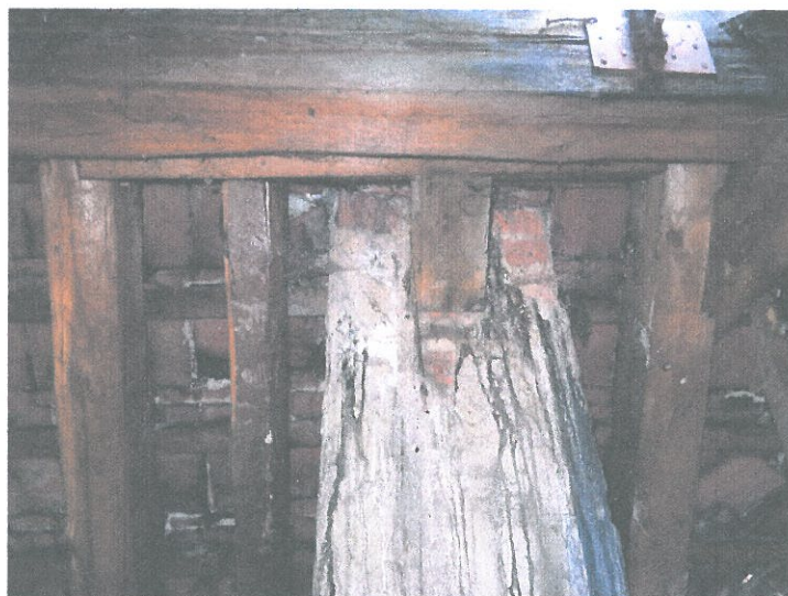
Uszkodzenia tynków i muru jednego z kominów w poziomie strychu
