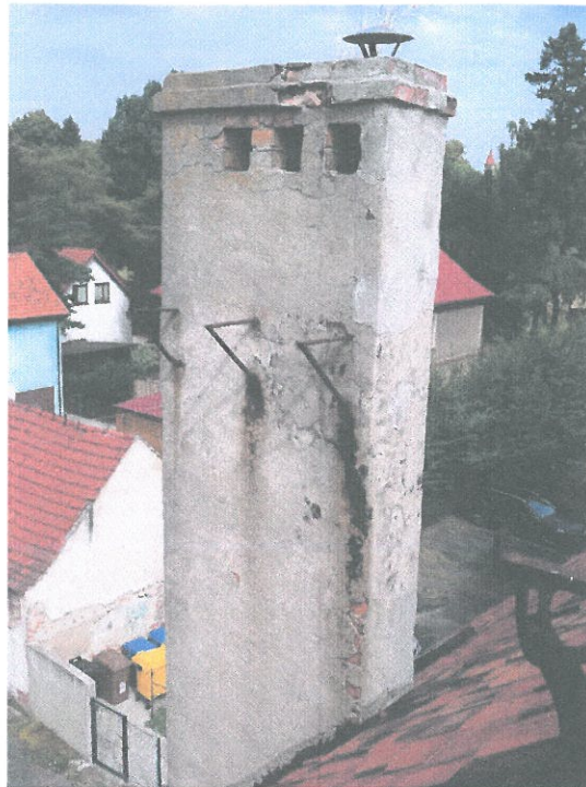
Uszkodzenia czapy i muru komina połączeni podwórzowej - uszkodzony fragment do przemurowania.
