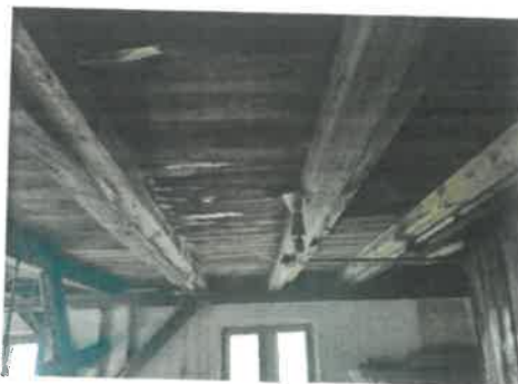
Fot. 8 ; 9 Spękanie belki. Korozja biologiczna elementów drewnianych. Przebarwienia. Zawilgocenie. Uszkodzenie, ubytki tynku. Nieprawidłowe wzmocnienia krokwi.
