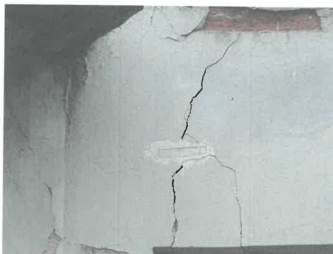
Pęknięcia ściany zewnętrznej klatki schodowej części mieszkalnej.
