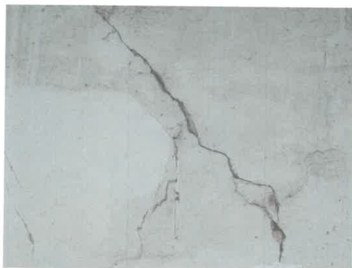
Pęknięcia ściany podwórzowej w poziomie piętra części gospodarczej.
