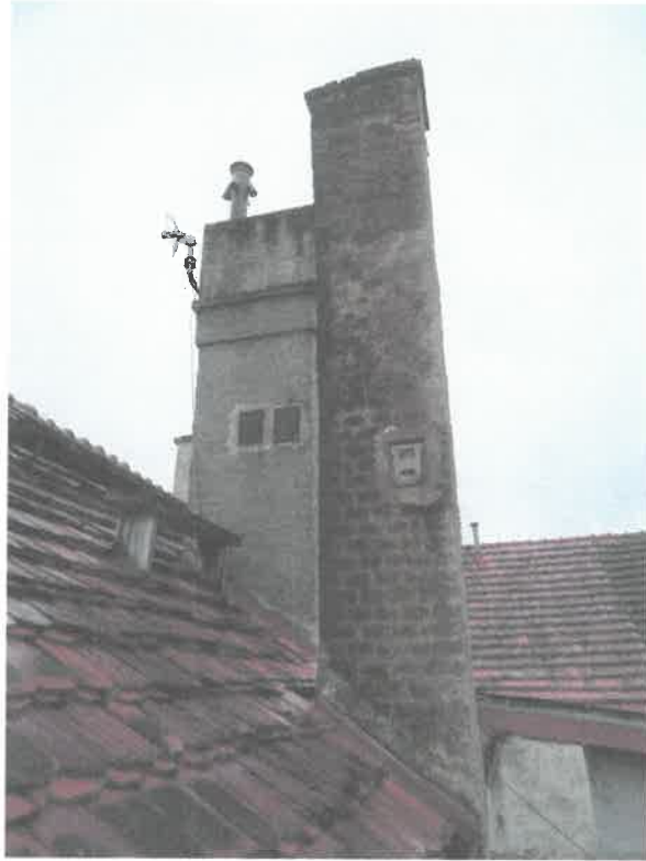
Uszkodzenia czapy i muru komina połaci północnej - uszkodzony fragment do przemurowania.
