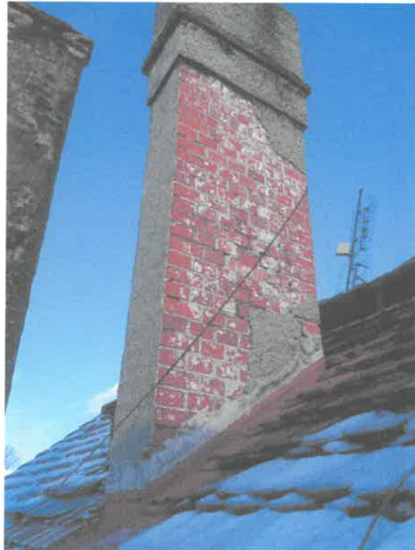
Odparzone tynki na kominie. Brak uszkodzeń muru kominowego
