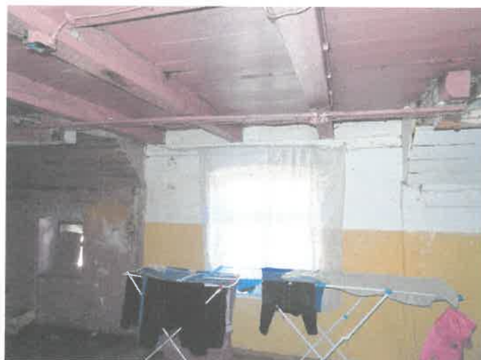
Wycięte słupy wspierające płatwie lukarny frontowej – do uzupełnienia.
