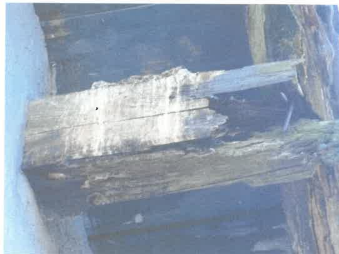
Uszkodzenia końcówki płatwi i krokwi zewnętrznej przy południowej ścianie szczytowej – do wymiany.
