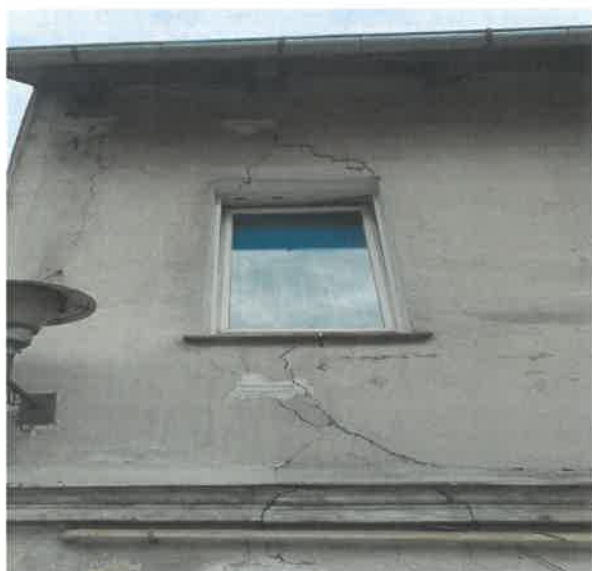
Zdj. nr 5 ; 6 uszkodzenia
